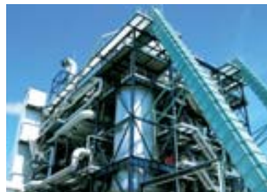
完成したバイオマスボイラー(日本製紙(株)勿来工場)
