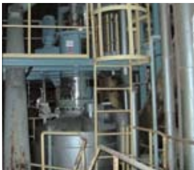
省エネルギー設備 黒液間接ヒーター (日本製紙(株) 釧路工場)
