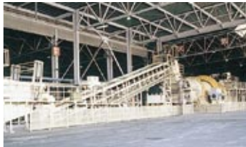
岩沼工場 DIP設備
