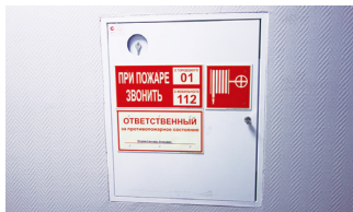
オフィス内に設置された消火設備
