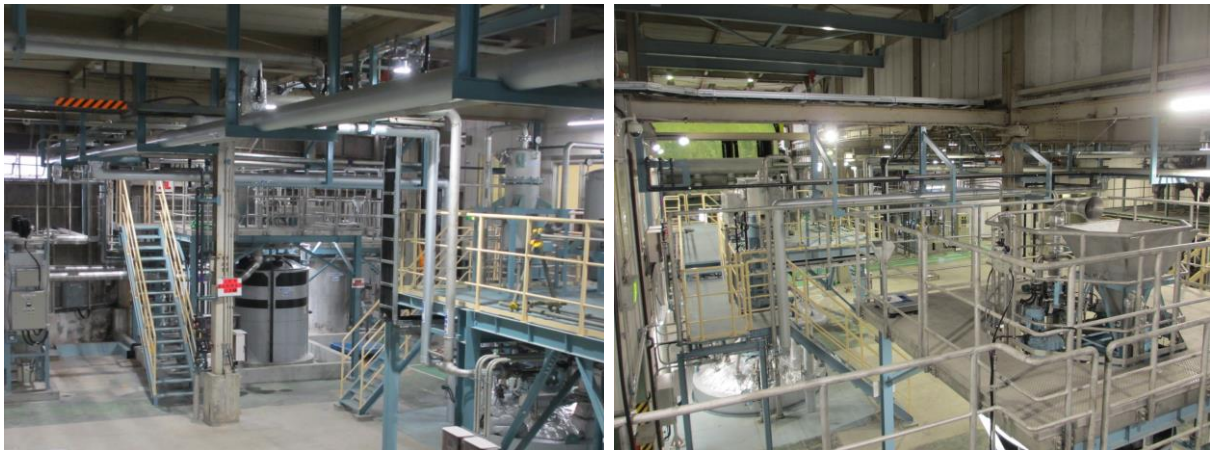
今回完成したミネルパ実証生産設備
