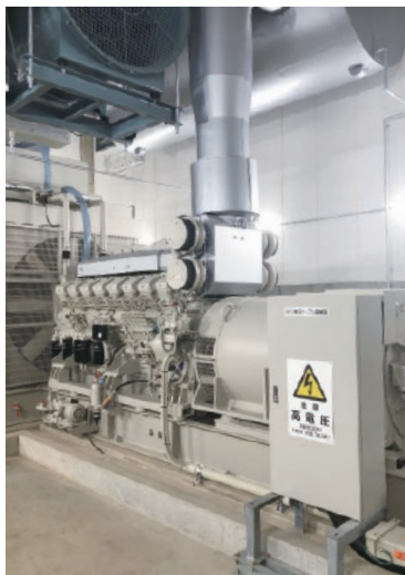
自家発電設備
